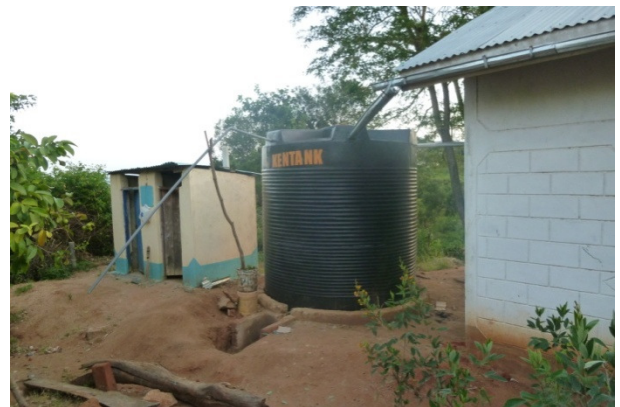
Tank der Gesundheitsstation, der seit zwei Jahren gut funktioniert
